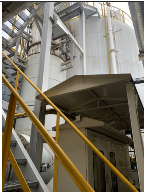
RTO燃烧装置
