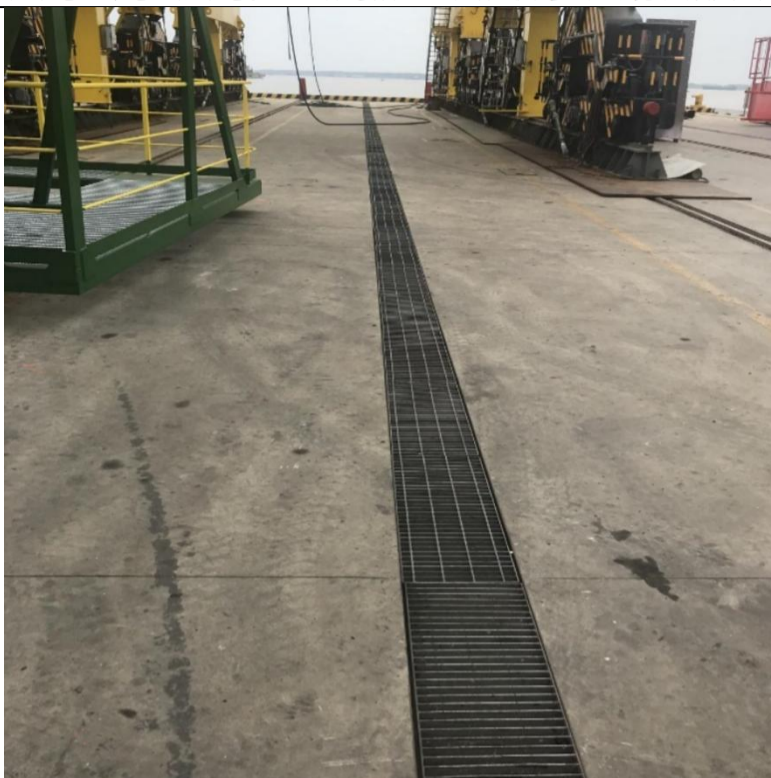
图 3.1.3-2 码头面初期雨水收集明沟
