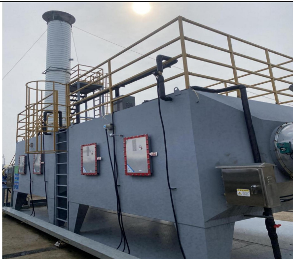
二级活性炭吸附装置及 20m 高排气筒（DA001）
